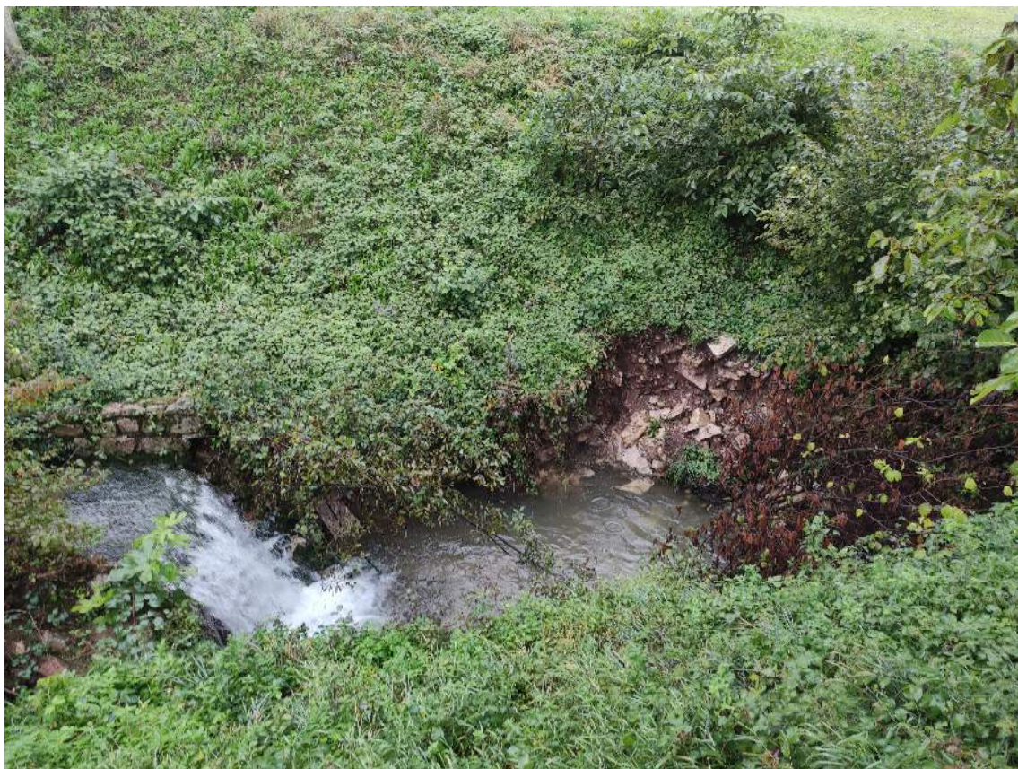
Foto 6: erosioni spondali a valle dello scarico del depuratore
